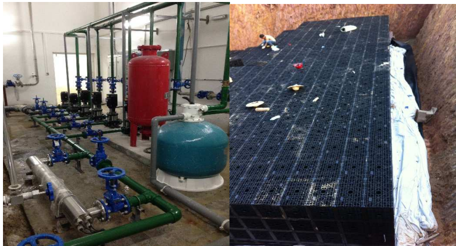
雨水处理设施 蓄水模块建设
