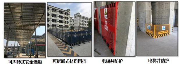
可周转式安全通道 可拆卸式材料围挡 电梯井防护 电梯井防护
