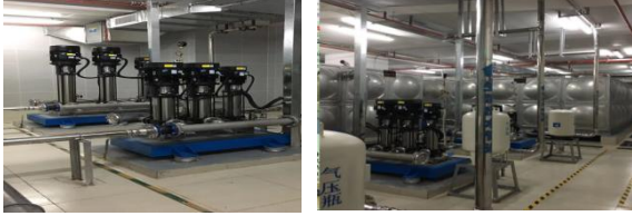
水泵房设备及基础排布整齐
