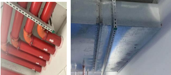
风管消防水管及风管穿墙封堵规范
