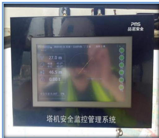
塔机安全监控系统
