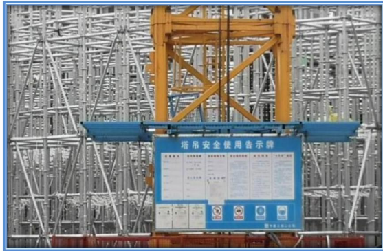
塔吊防攀爬防护
