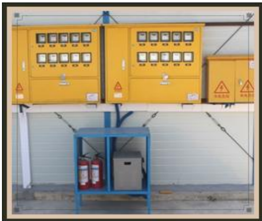
生活区低压配电
