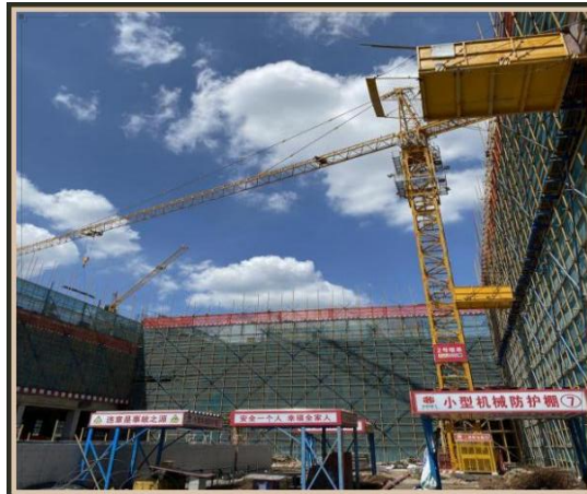
悬挑卸料平台
