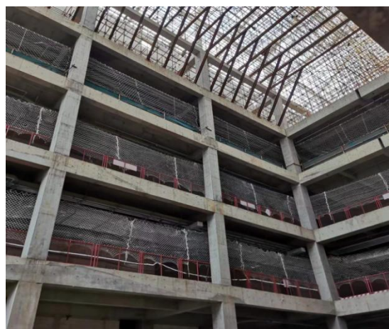
临空立网防护
