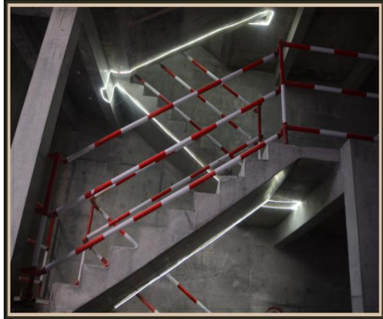
楼梯间 LED 照明灯带
