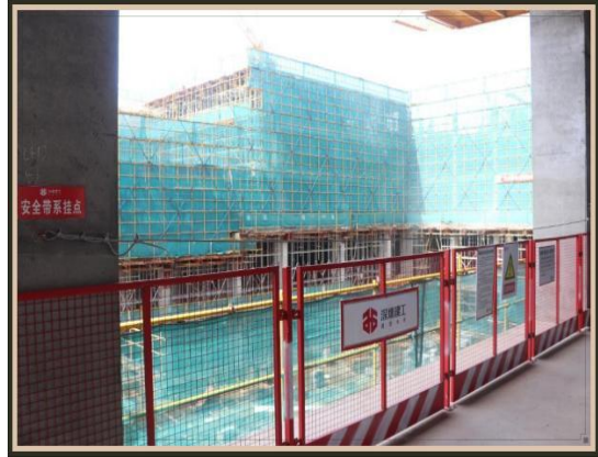
楼层临边防护
