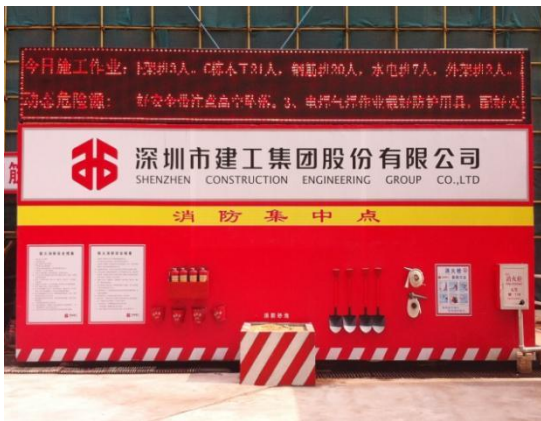
消防设施集中点
