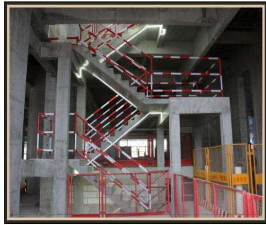
楼梯临边防护
